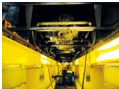
Dank dieses Schachts kann bei bestem Licht am Unterboden der Schienenfahrzeuge gearbeitet werden.
