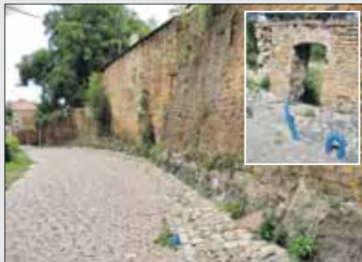
Auf dem neuen Weg entlang alter Mauern wird auch eine Beleuchtung installiert. Die Leitungen sind schon da.
